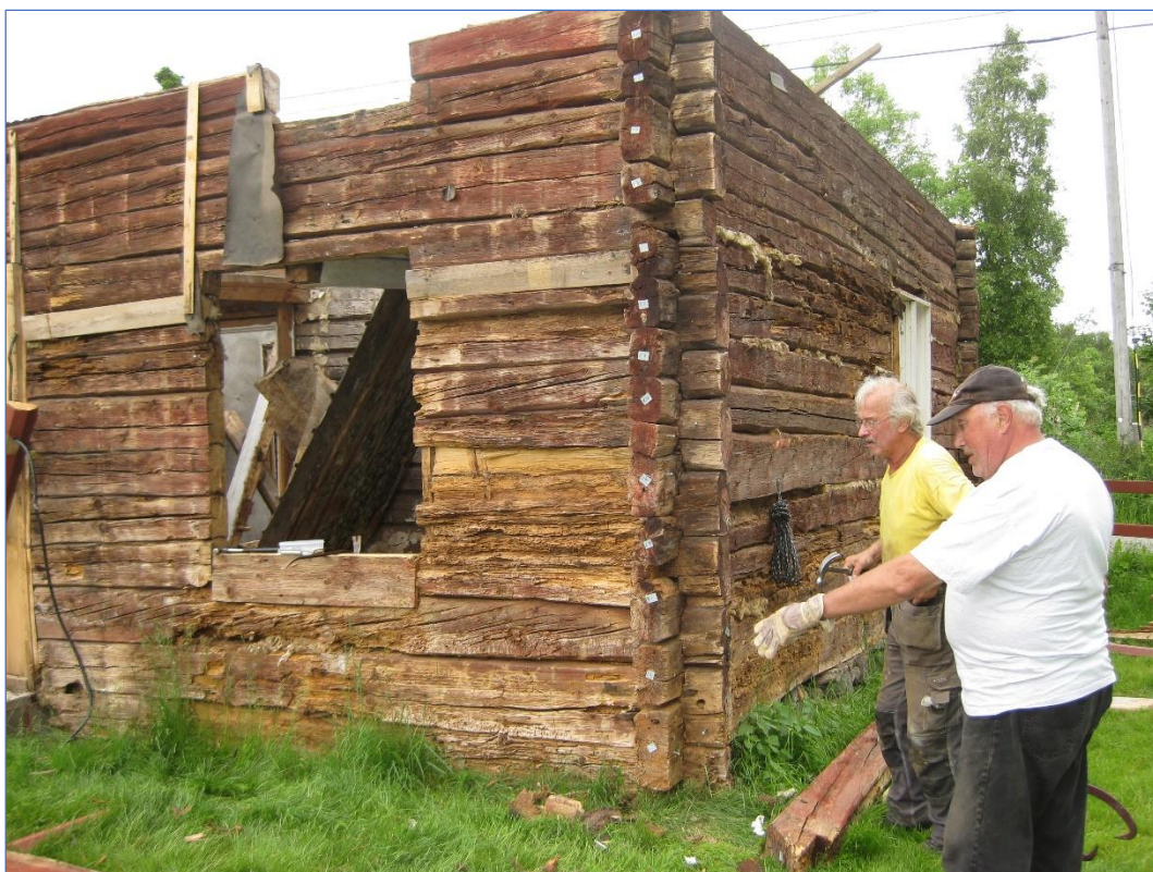
När de röda facadbrädorna tagits bort såg huset inte längre så prydligt ut.
